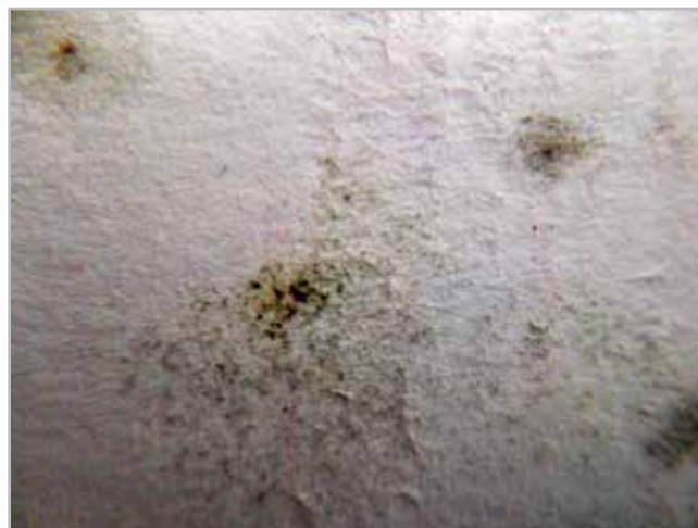
Figura 7.- Ataque biológico en el reverso de una obra Face-mounting carente de elemento protector trasero. Fuente: Elaboración propia.
