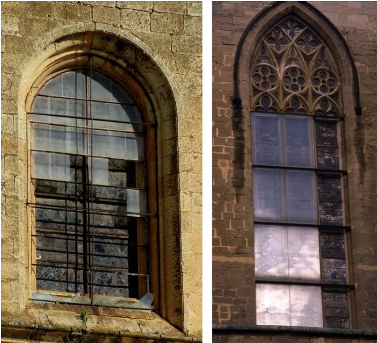
Figura 3. Roturas y pérdidas de vidrios en los acristalamientos de protección. Izquierda: Catedral de Segovia; derecha: Catedral de Manresa (Barcelona).
