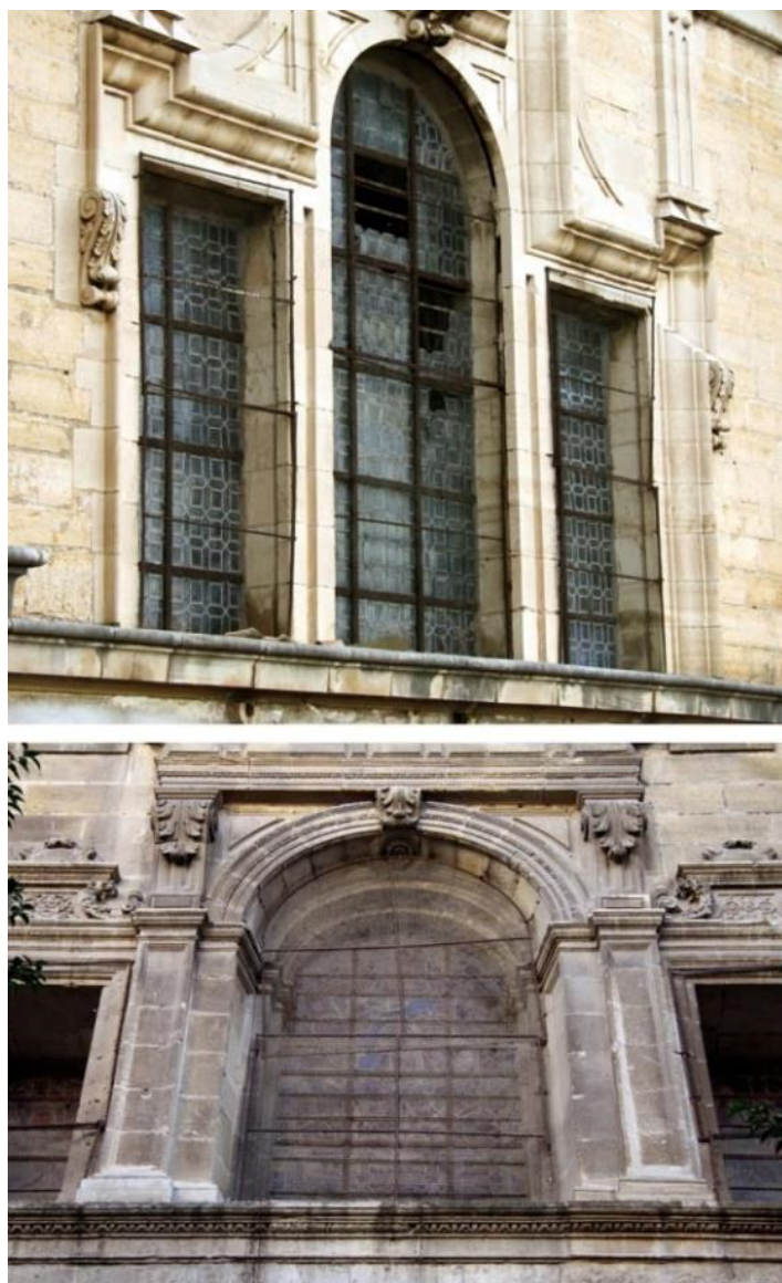
Figura 4. Deterioros en las mallas de protección de las vidrieras. Superior: catedral de Jaén; inferior: catedral de Granada.
