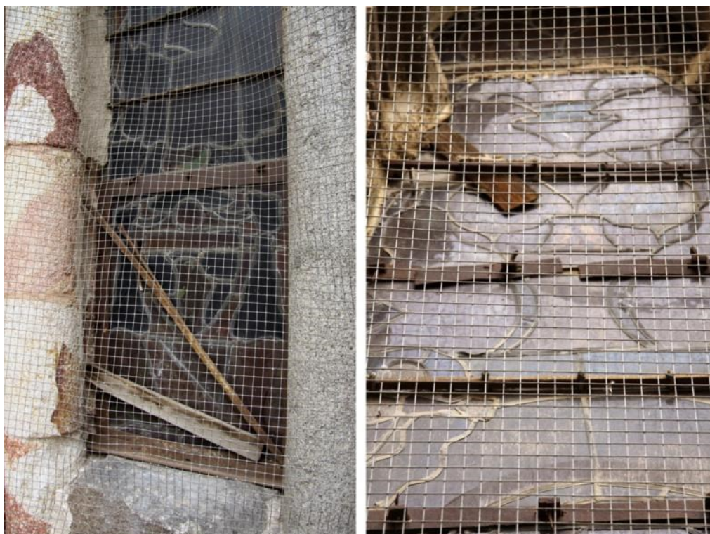
Figura 2. Mal estado de elementos metálicos, morteros y masillas en algunas vidrieras de la catedral de Ávila.
