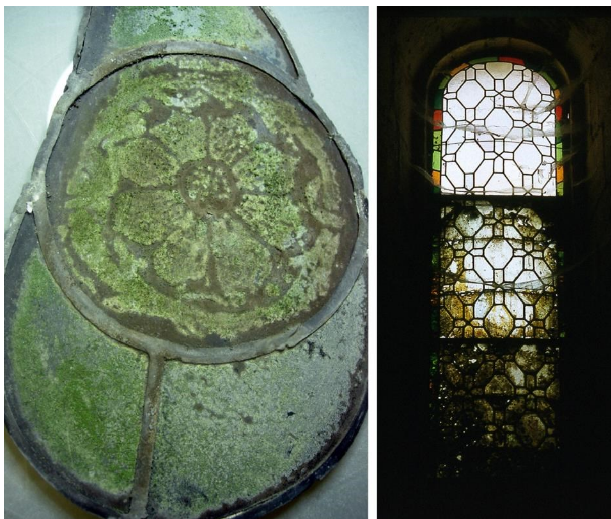
Figura 5. Diferentes daños de origen biológico relacionados con un elevado porcentaje de humedad en el interior del edificio y una deficiente ventilación. Izquierda: Cartuja de Miraflores (Burgos); derecha: monasterio de Santes Creus (Tarragona).
