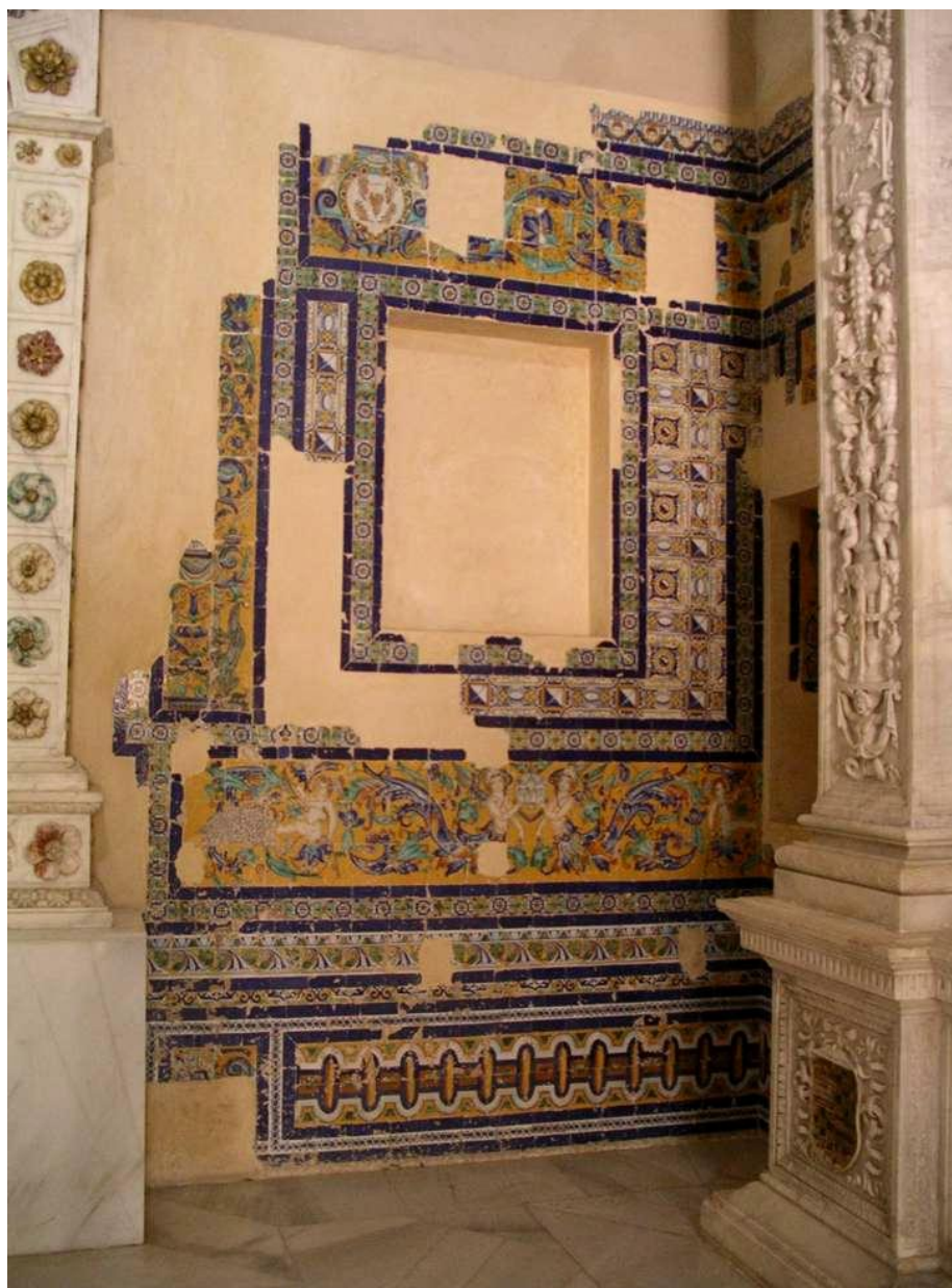
Figura 9. Caso de reintegración excesiva de morteros en grandes lagunas. Monasterio de la Cartuja, Sevilla (J.J. Lupión).
