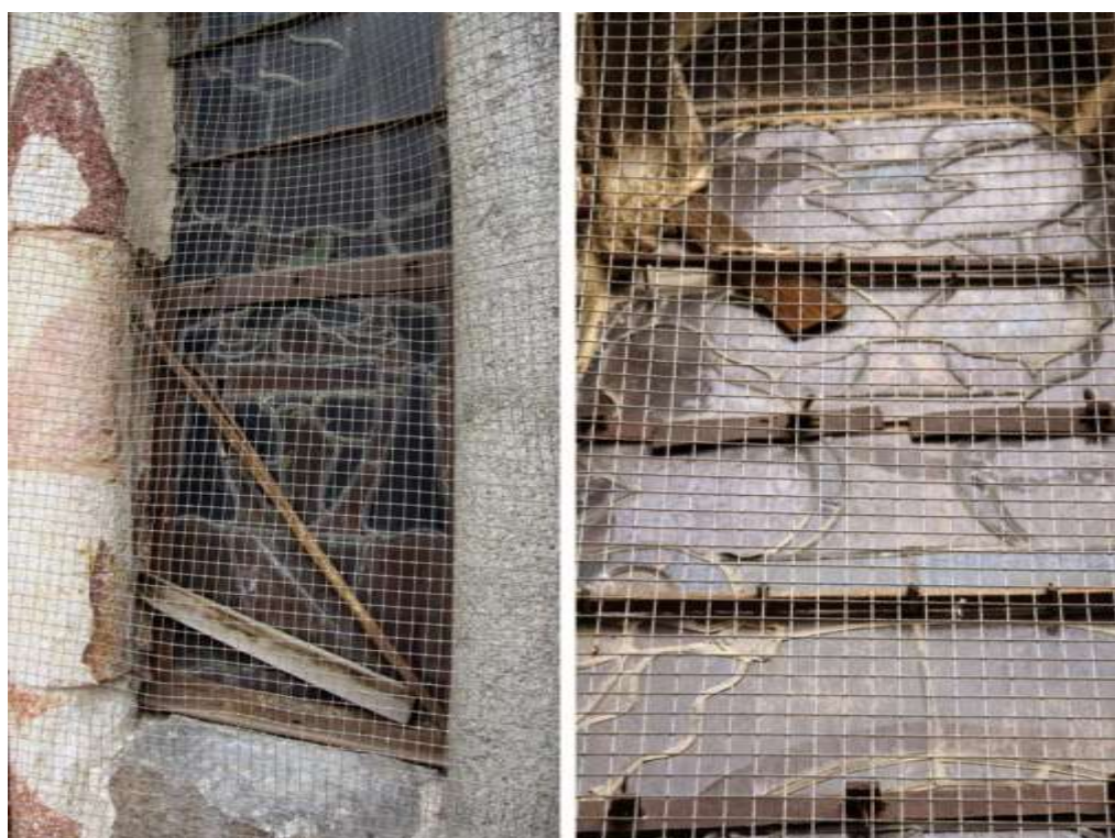
Figura 2. Mal estado de elementos metálicos, morteros y masillas en algunas vidrieras de la catedral de Ávila.
