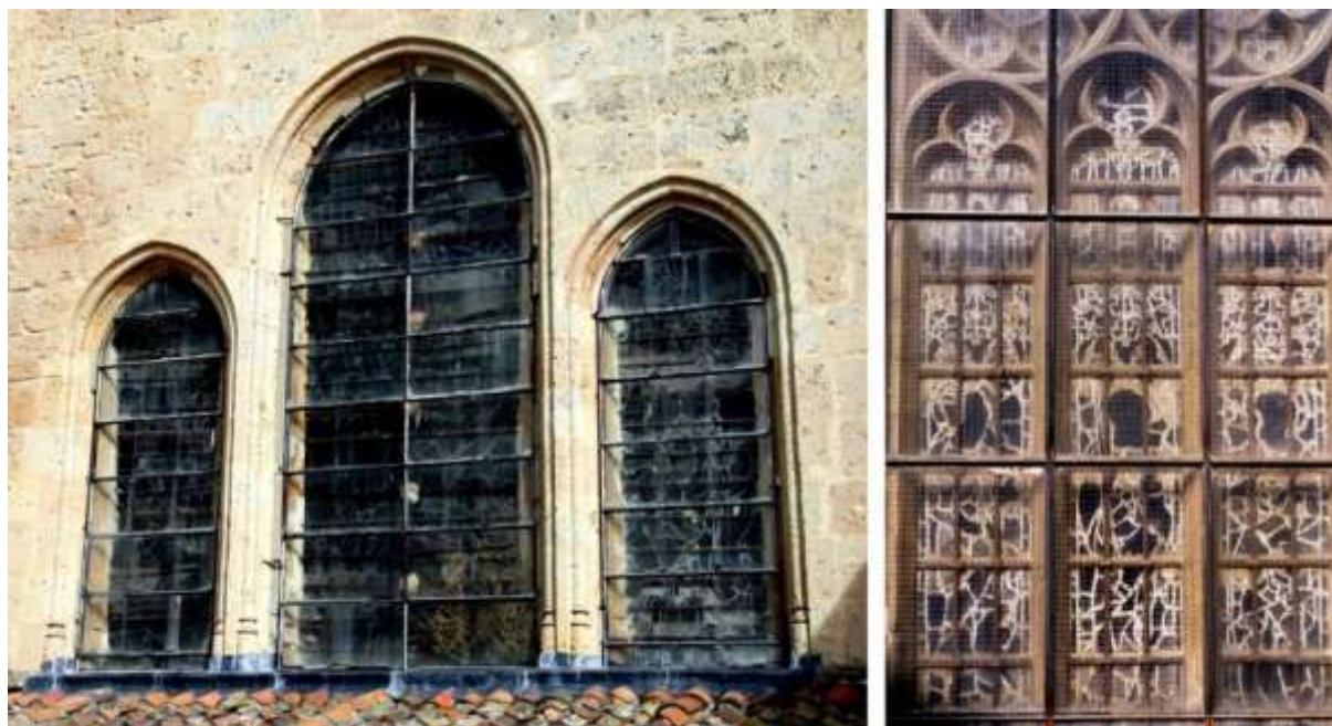
Figura 8. Crecimiento vegetativo y carbonatación de plomos como consecuencias de acristalamientos de protección sin ventilación. Izquierda: catedral de Segovia; derecha: catedral de Girona.
