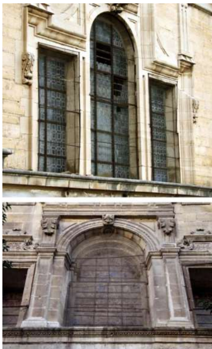
Figura 4. Deterioros en las mallas de protección de las vidrieras. Superior: catedral de Jaén; inferior: catedral de Granada.
