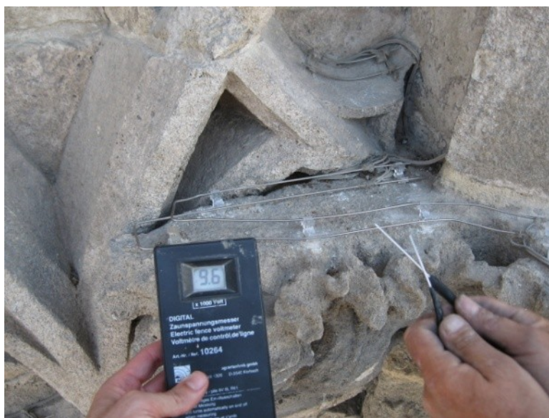
Foto 3- Comprobación del correcto funcionamiento del sistema electrostático en la portada de los Palos.
