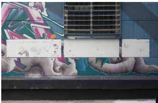
Figura 4. Superficie mural tras tres arranques parciales a strappo .
