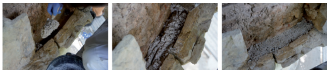
Figura 10.- Preenchimento do sistema de escoamento de águas pluviais, já descaracterizado por intervenções anteriores..
