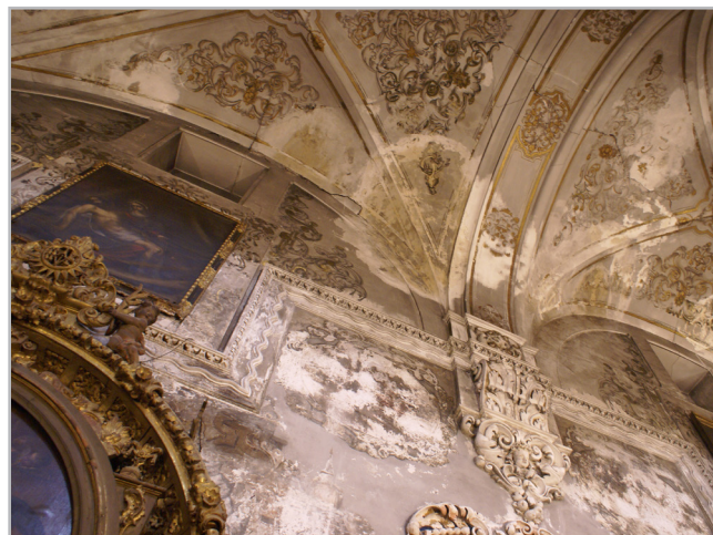
Figura 4.- Las patologías del inmueble, como filtraciones procedentes de las cubiertas, se convierten en agentes de deterioro de los retablos.
