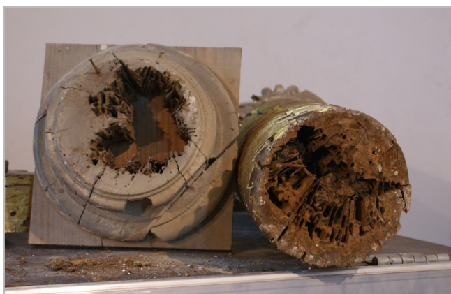
Figura 3.- Incidencia del biodeterioro (termitas).
