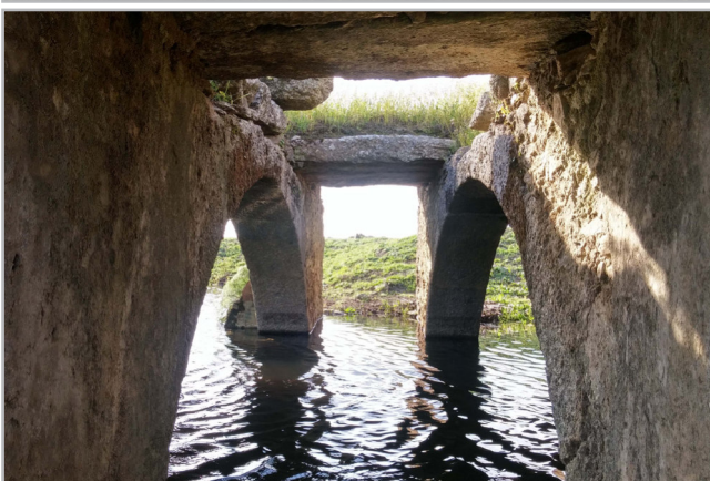
Figura 7.- Cárcavo del centro de la nave, visto por debajo y por arriba. No se trata de un “hundimiento”, sino de un espacio rectangular configurado para un fin. Fuente: Elaboración propia
