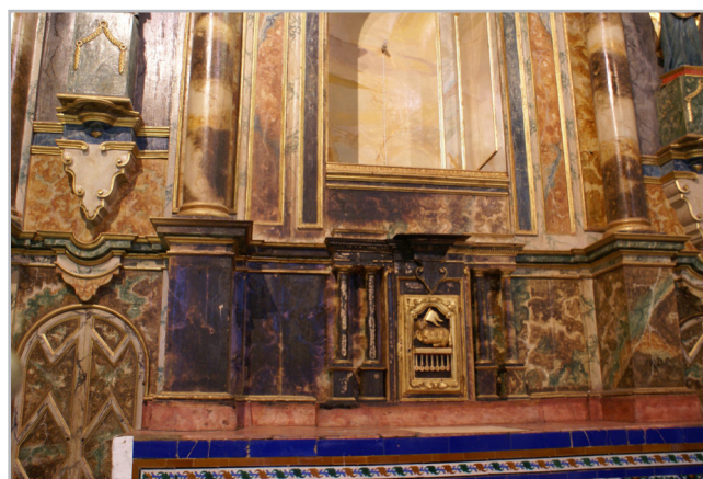
Figura 1.- Retablo parcialmente carbonizado tras verse afectado por la caída accidental de varias velas.
