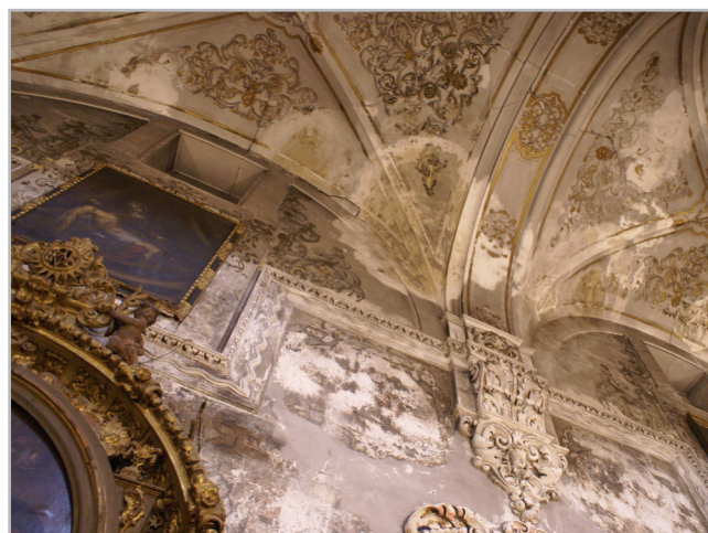
Figura 4.- Las patologías del inmueble, como filtraciones procedentes de las cubiertas, se convierten en agentes de deterioro de los retablos.
