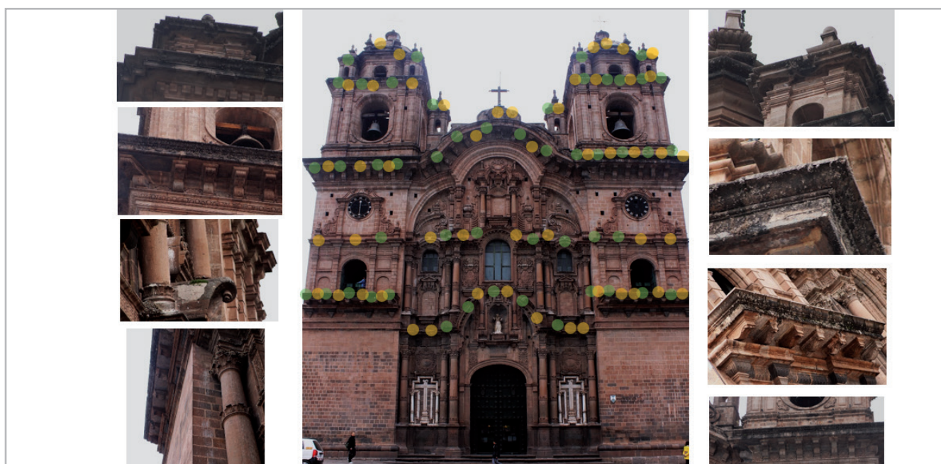
Figura 2. -Estado patológico de la Iglesia de la Compañía de Jesús, Las manchas verdes representan presencia de musgo, y las amarillas de líquenes. Fuente: propia
