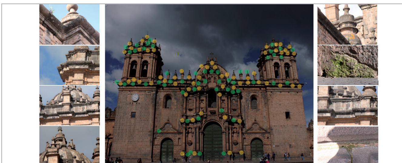
Figura 1. -Estado patológico de la Basílica Catedral de Cusco. Las manchas verdes representan presencia de musgo, y las amarillas de líquenes. Fuente: propia
