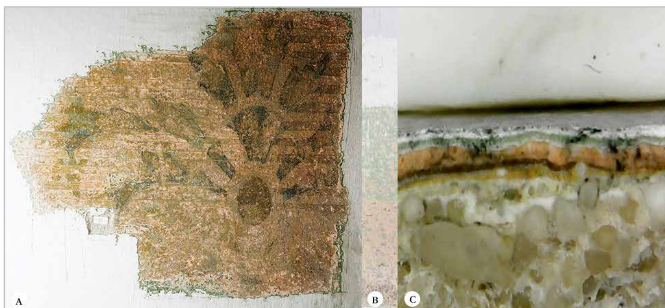
Figura 5.- A: Imagen del diseño estampado con la técnica del estarcido. B: Imagen de la cata próxima al motivo descubierto. Se observan, desde abajo hacia arriba, las tonalidades de las capas de pintura que lo cubrieron sucesivamente. C: Imagen estratigráfica, obtenida del mismo sector.
