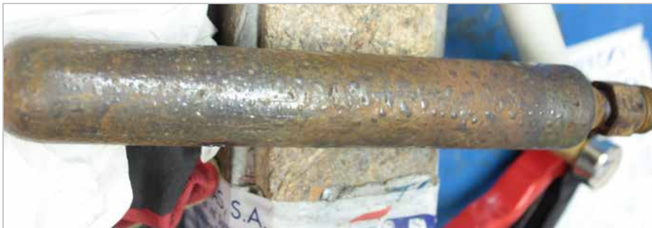
Figura 10.- Corrosión generalizada y ampollamiento del recubrimiento en el botellín de presión del extintor de agua desmontado.
