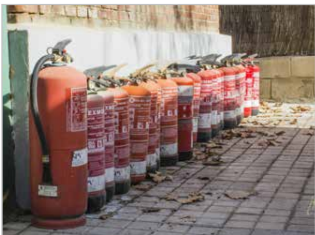
Figura 3.- Extintores almacenados en el exterior del almacén del MUNCYT.
